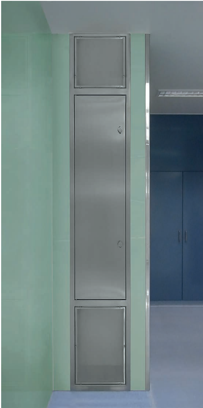
Abluftschrank inklusive Flusenabscheider und Servicetür
