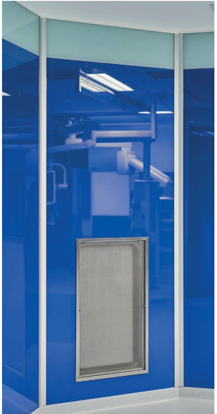
Abluftschrank hinter Glaswand positioniert mit integriertem Flusenabscheider
