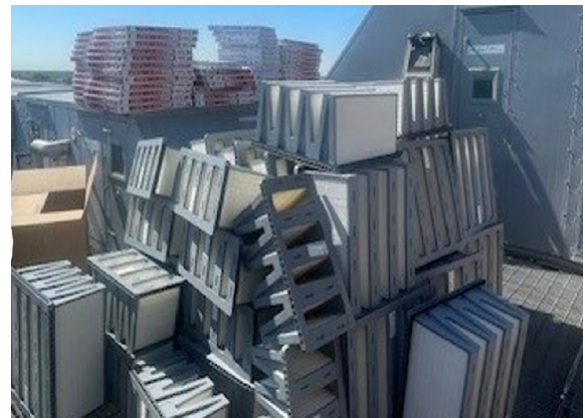
Les filtres MERV 16 V-Bank qui ont été remplacés
