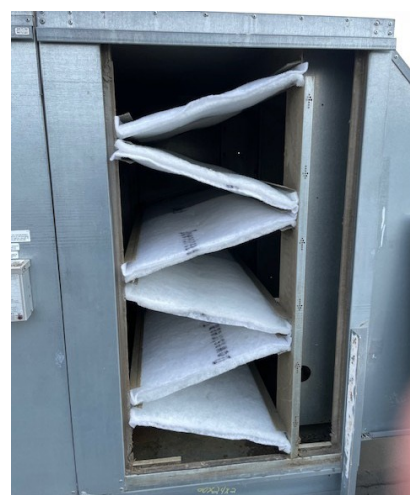
APRÈS LES FILTRES M+H
